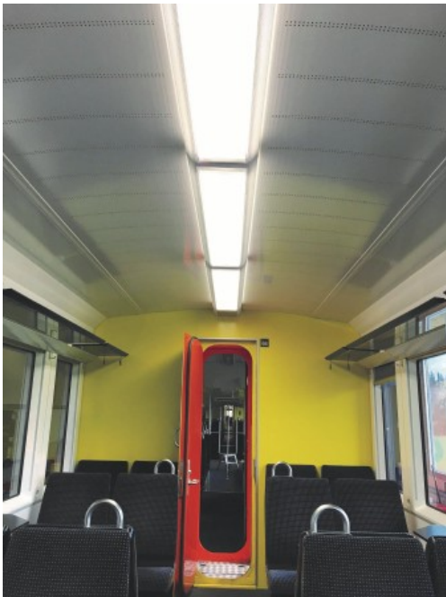
T8 tubular lights
